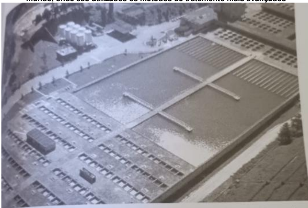
Figura 42 - ETA do Guaraú, na região da Cantareira, em São Paulo. Uma das três maiores do mundo, onde são utilizados os métodos de tratamento mais avançados
